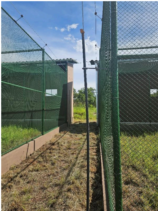
Aterramento SPDA Autoria: Carolina Rodrigues Bordignon Data:29/11/2023
