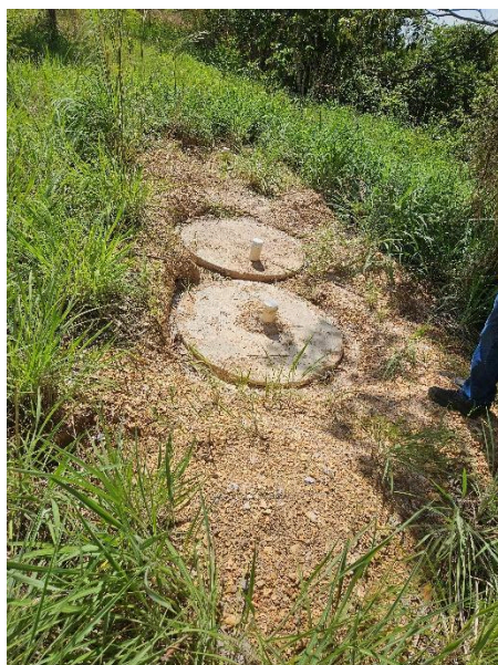
Fossas sépticas instaladas Autoria: Carolina Rodrigues Bordignon Data:29/11/2023
