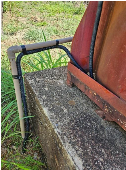
Fiação protegida Autoria: Carolina Rodrigues Bordignon Data:29/11/2023
