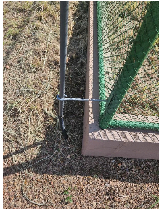
Aterramento SPDA Autoria: Carolina Rodrigues Bordignon Data:29/11/2023
